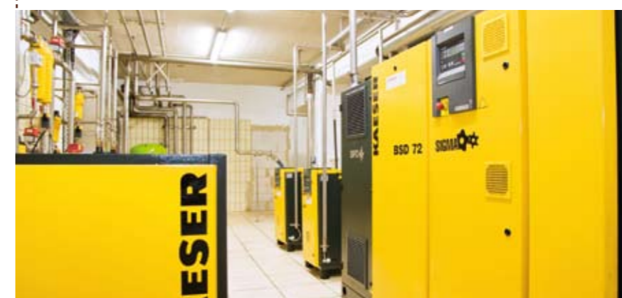
Ustersbašská stanice stlačeného vzduchu
