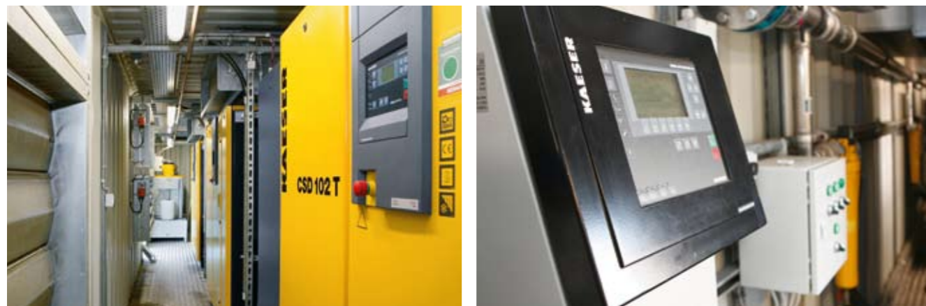
Stlačený vzduch a topnou energii pro přípravu teplé vody dodává tato stanice na smluvní dodávku, zařízení je instalováno v kontejneru a nanejvýš efektivně řízeno „Sigma Air Managerem.“
