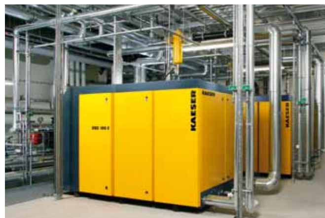
Tato velká, dobře umístěná, plně integrovaná stanice stlačeného vzduchu dodává jak stlačený vzduch, tak i teplo do teplovodního systému
