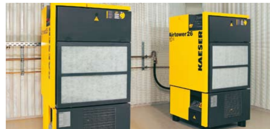
Dvě vzduchové věže denitrifikační jednotky v Bisambergu (Dolní Rakousko)
